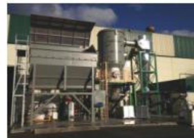
Gasificación de MBM para vapor 10 MWth. Salamanca, España
