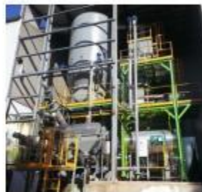
Gasificación de MBM para vapor 16 MWth. Oporto, Portugal
