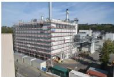
Gasificación de MBM para Cogeneración 18 MWth. Lyss, Suiza
