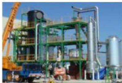
Gasificación de Biomasa para Cogeneración. 2.0 MWe. Zaragoza, España
