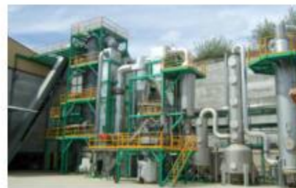
Gasificación de Biomasa para generación eléctrica. 1.6 MWe. Valencia, España
